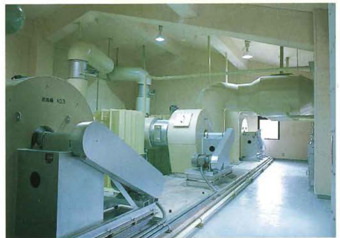
炉室2階（機械室）
